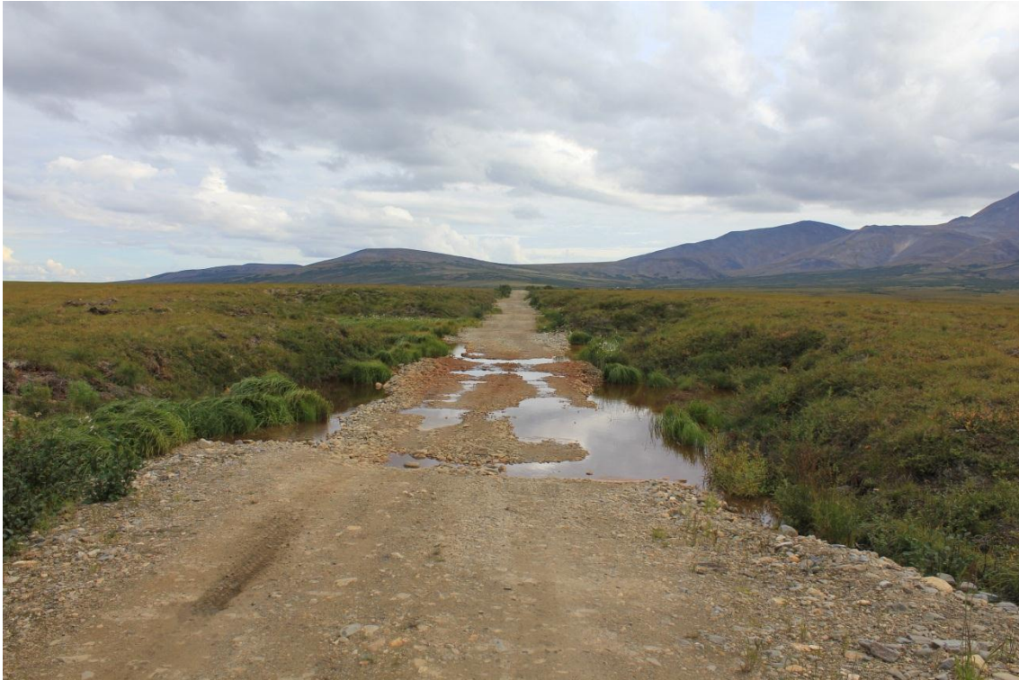
Efectos del derretimiento de permafrost en un camino de Alaska. Foto: John Cloud, NOAA Central Library
